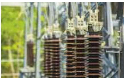
Hochspannungsisolatoren in einem Umspannwerk (Quelle: Westerwälder Tonkiste)
